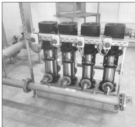
Pumpenstaffel der DEST in Gimmel
